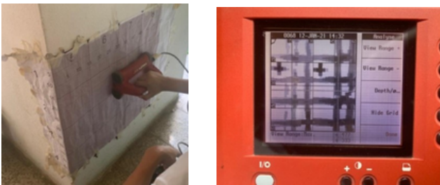
Figura 7. Se evaluó en forma de Escáner elementos principales del primero, segundo y tercer nivel según como indica la teoría y se realizó en base a los procedimientos de la presente evaluación. Fuente: Elaboración propia.
